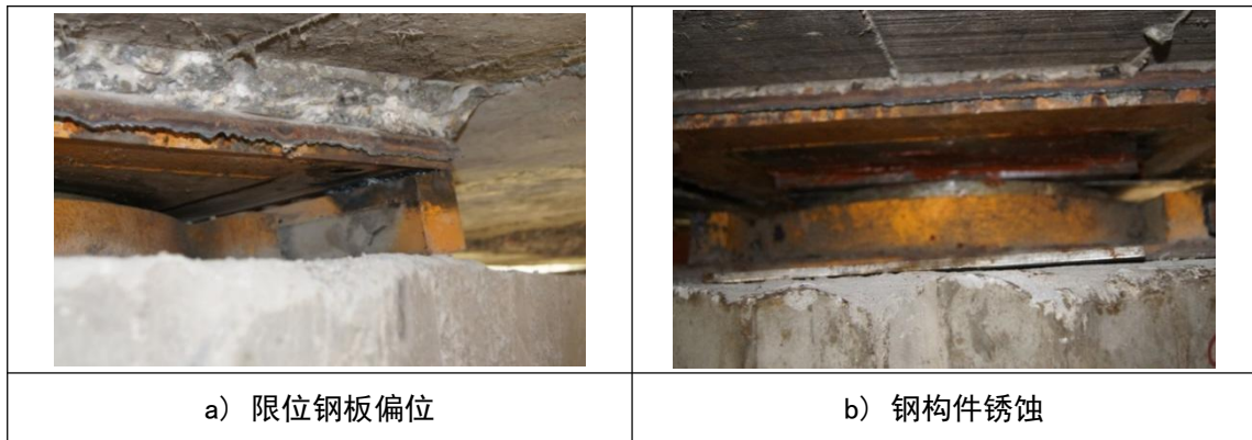
图 A.2 盆式橡胶支座病害
