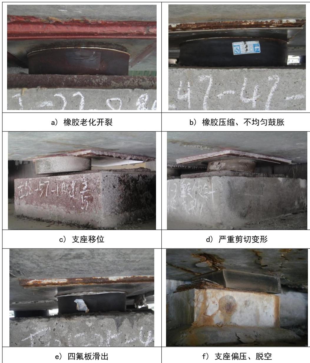
图 A.1 板式橡胶支座病害
